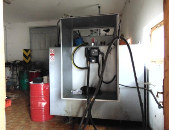
Čerpací stanice nafty v přístavku u dílen
