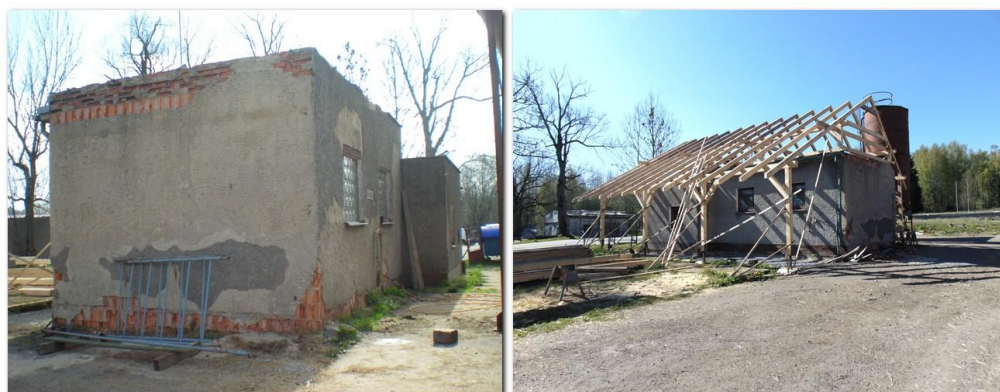
Původně úpravná vody se v roce 2016 rekonstruuje na sociální zařízení pro zaměstnance ( foto 13.4 + 17.5)
