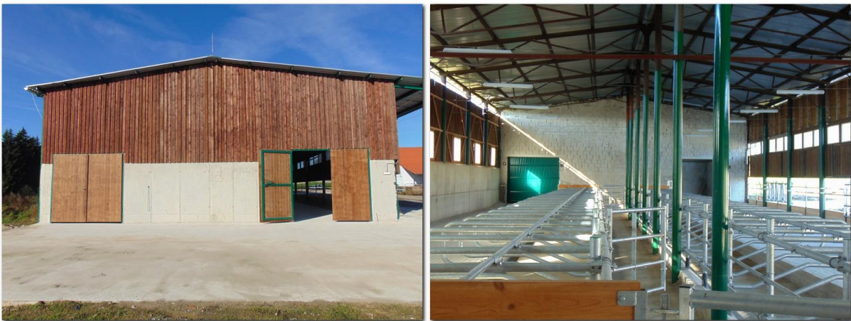
Rekonstrukce ocelokolny na stáj – Muckov 3 je prakticky ukončena a dne 3. října 2014 proběhne kolaudační řízení ( foto 29.9)
