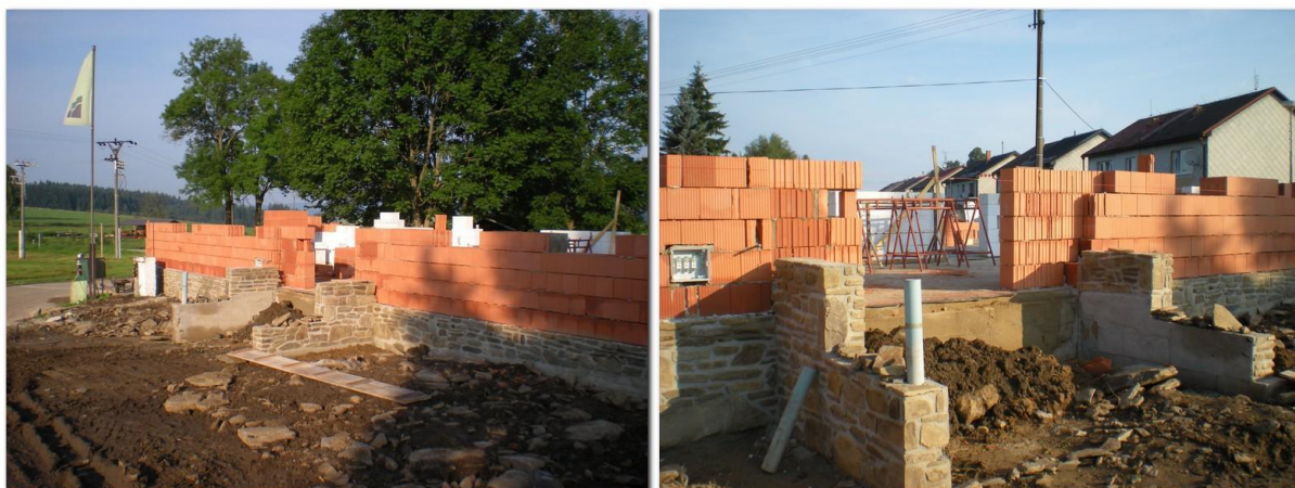
Začátkem srpna je již kamenný sokl postaven a stavba pokračuje podle projektu/7.8.2014/
